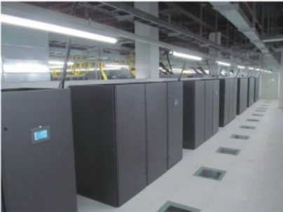
银行 IDC 中心
