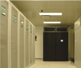
60KW 风冷型机房空调，风帽上送风。
