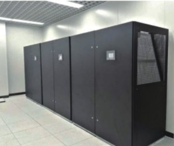
80KW 冷水型机房空调，地板下送风。
