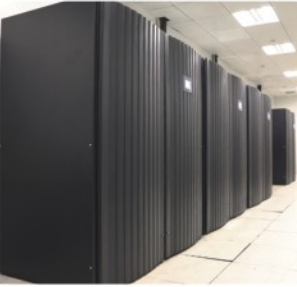
80KW 风冷型机房空调，地板下送风。
