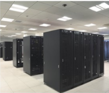
小型数据中心
