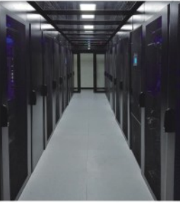
40KW 风冷列间空调，封闭冷通道。
